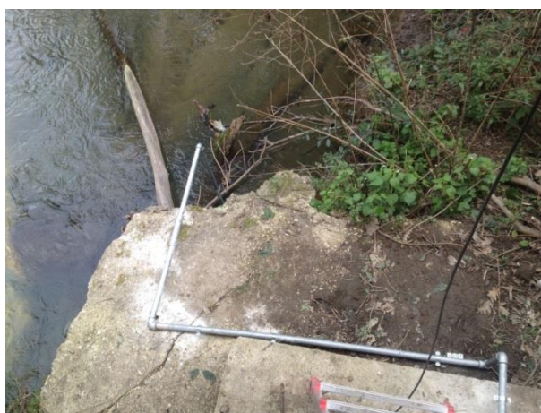
Figura 61. Particolare dell'idrometro di Formello
