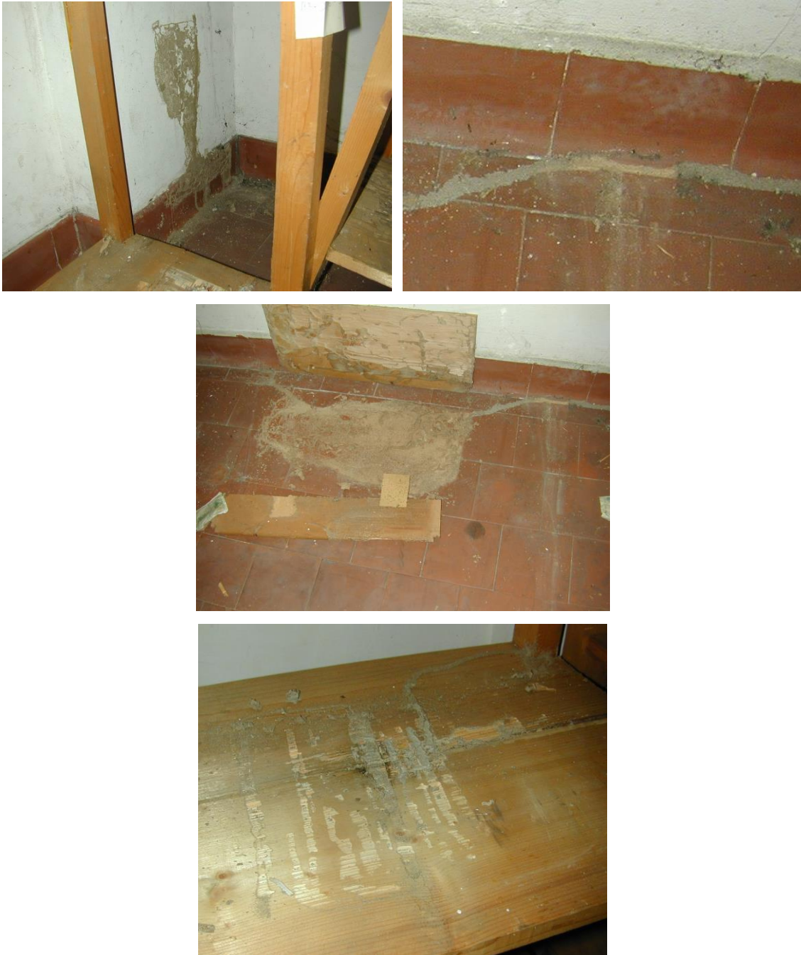
Figg. 3.5, 3.5a, 3.5b, 3.5c - Caratteristici “camminamenti” termitici sul muro, sul pavimento e sulla scaffalatura di un locale di deposito archivistico
