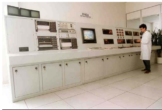
Fig.C1-8 Sala Controllo Impianto SPES
