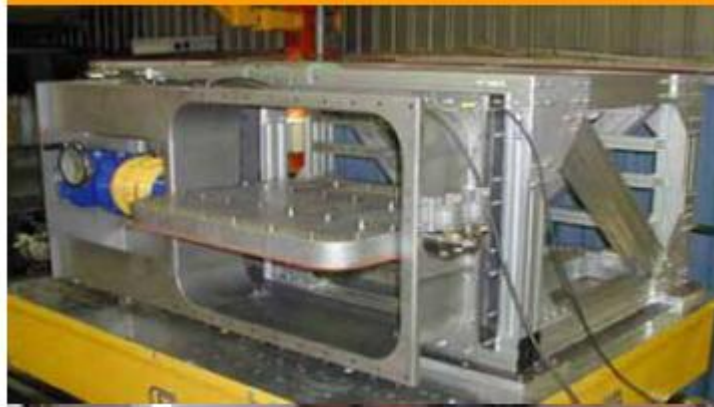
Figura 15: Saracinesche per la circolazione dei gas verso la riserva di acqua (vedi Figura 17). Normalmente aperte
