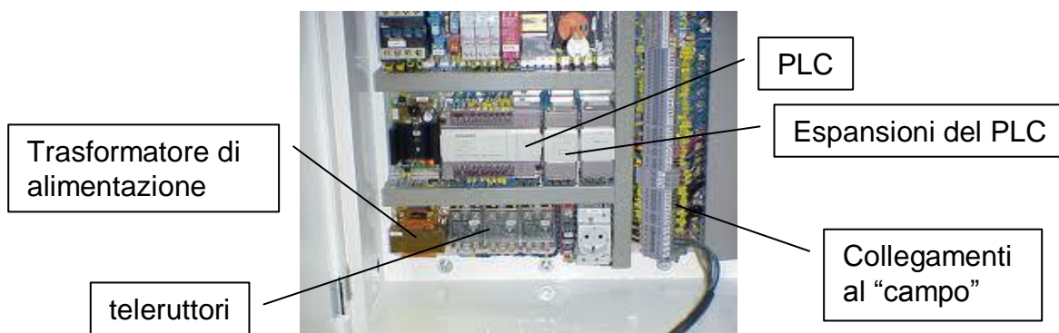
Fig.9: quadro elettrico con PLC
