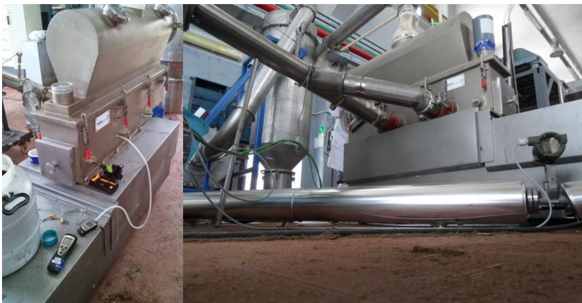
Figura 45: Foto dell'impianto di detossificazione.
