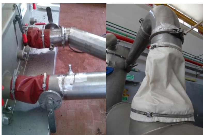
Figura 17: Raccordi flessibili per il collegamento del flusso di aria al letto vibrante (a sinistra), e per il collegamento al ciclone di cattura delle polveri (a destra).
