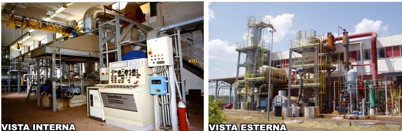
Fig. 2 – Impianto ST.E.LE. del Centro Ricerche ENEA della Trisaia
