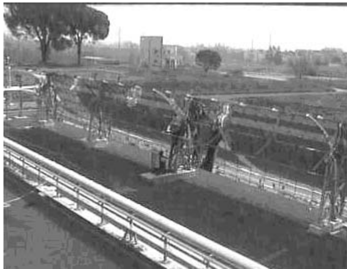
Figura 6-1 –Collettori solari dell’impianto PCS dell’ENEA Casaccia
