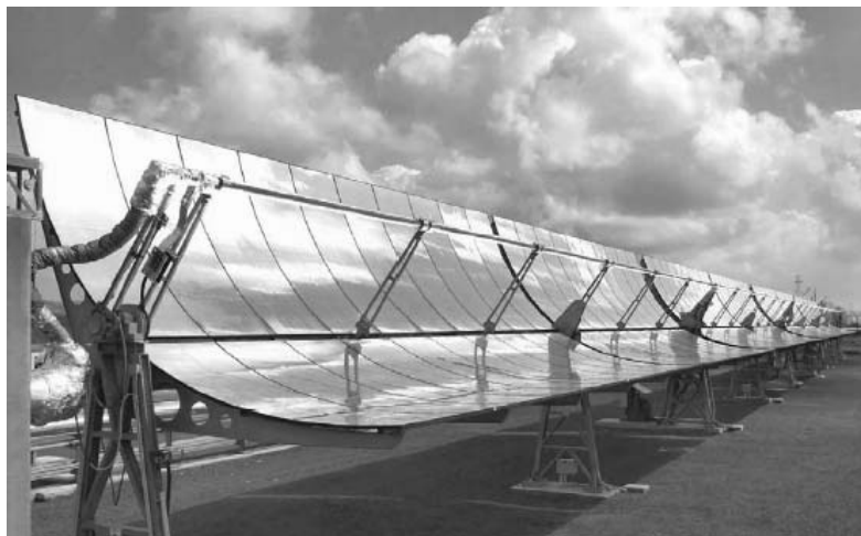
Figura 1-1 – Collettori solari parabolico-lineari ENEA (Impianto PCS)
