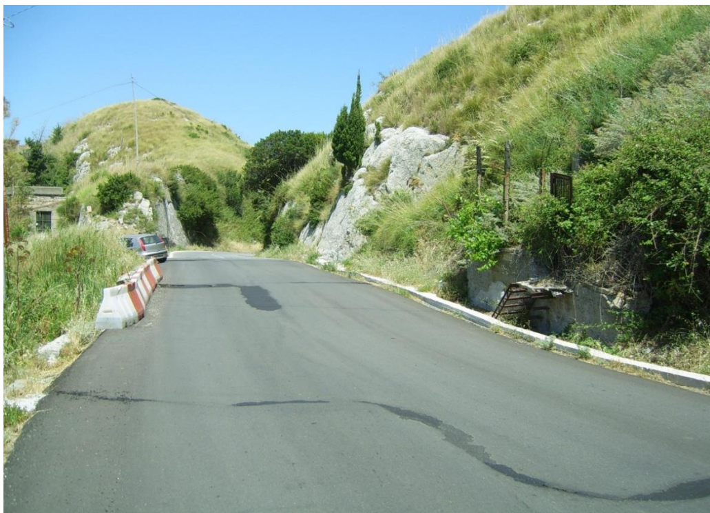
Figura 28 - Danni causati alla sede stradale dal lento ma continuo movimento traslazionale in località Gesso
