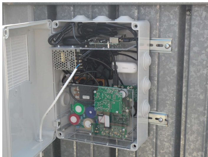
Figura 7. Foto dell'interno di un Airbox in fase di installazione.
