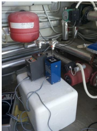
Fig.2, Taratura sul campo dei sensori di temperatura PT100
