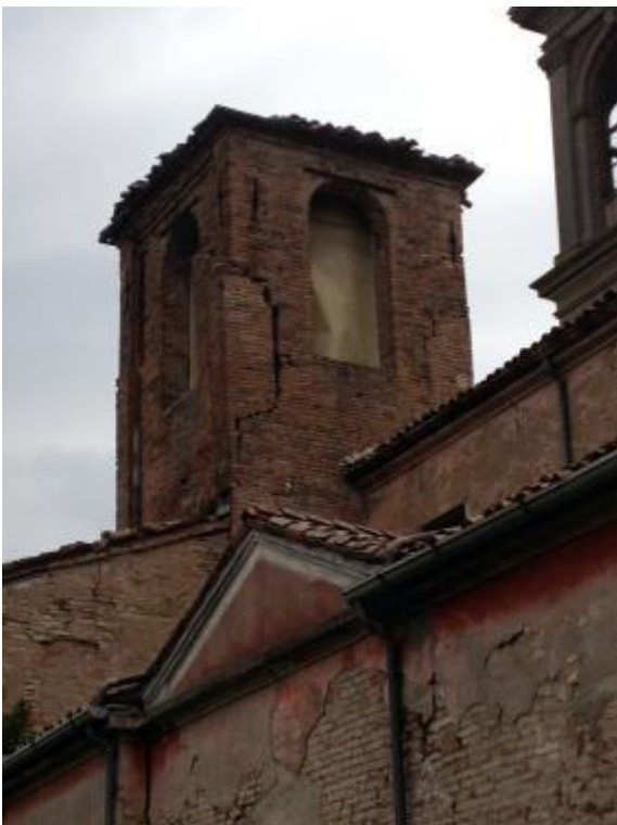
Fig. 15 Espulsione dei cantonali della cella campanaria
