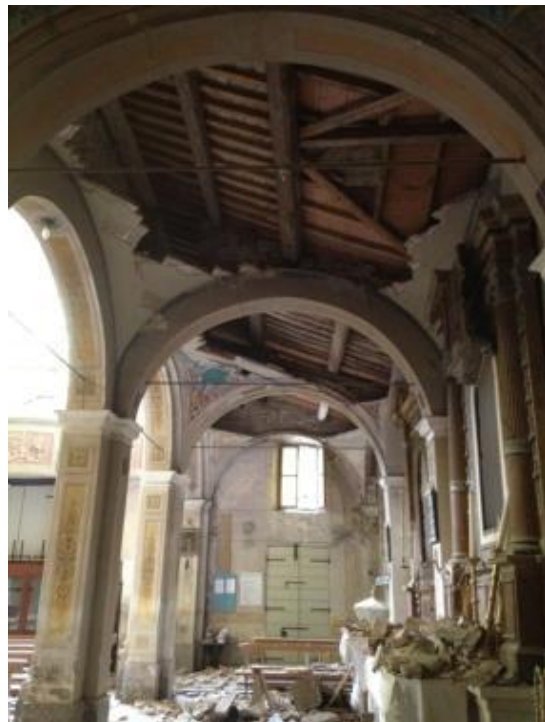
Fig. 5 Le volte crollate della navata sinistra
