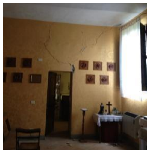
Fig. 12 Lesioni sulla parete della sacrestia
