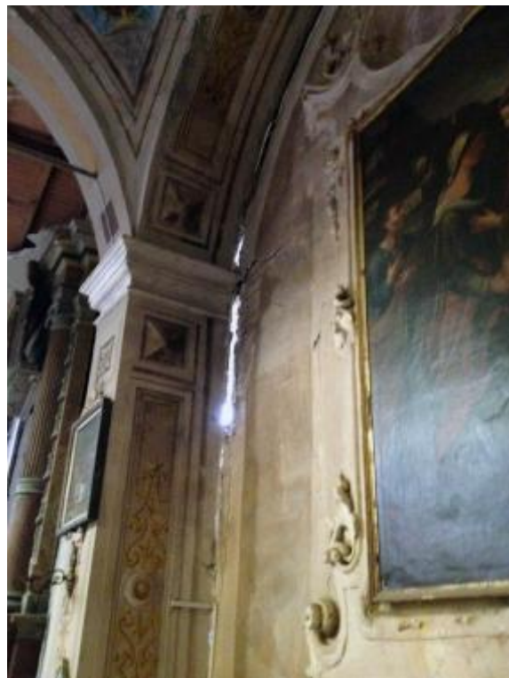
Fig. 14 Ribaltamento parete della navata sinistra
