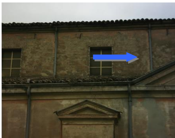
Fig. 9 Lesione sulla navata centrale (vis)
