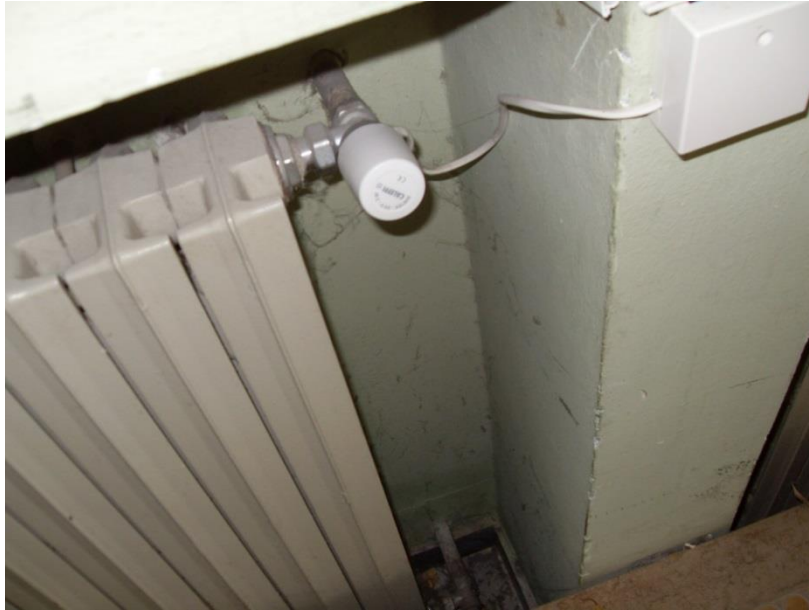
Fig. 11 – Radiatore con rilevatore di temperatura
