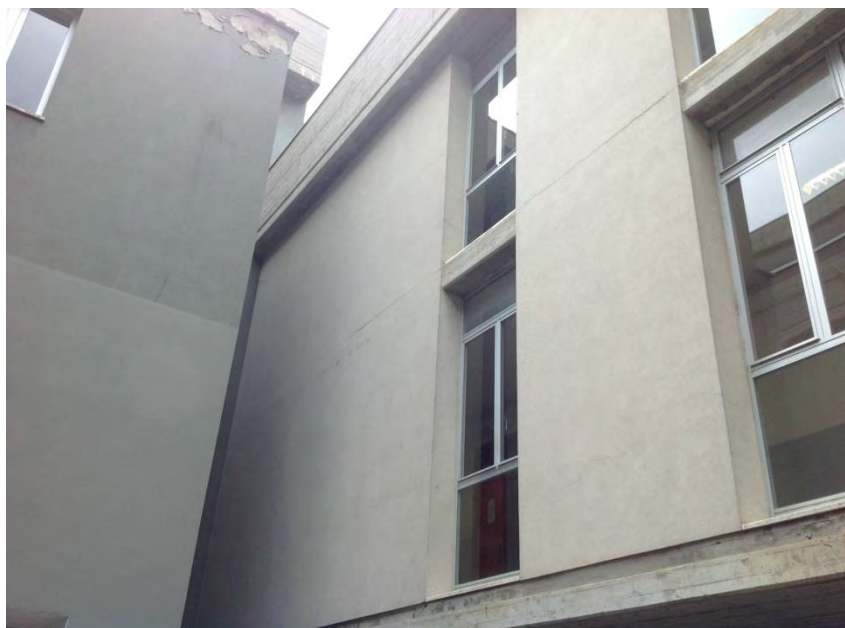
Fig. 51 – Scrostature in prossimità del tetto giardino
