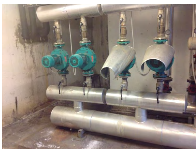
Fig. 3 – Sottocentrale della scuola media
