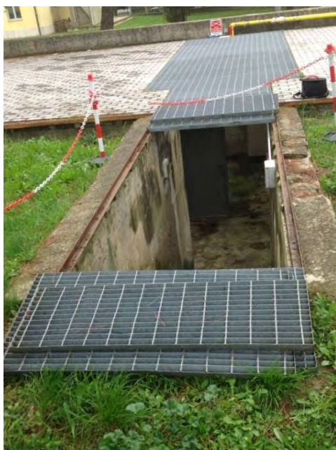
Fig. 2 – Accesso alla sottocentrale
