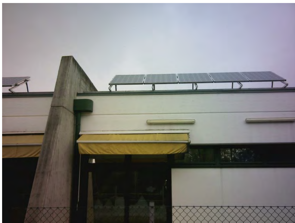
Fig. 49 – Impianto fotovoltaico in copertura
