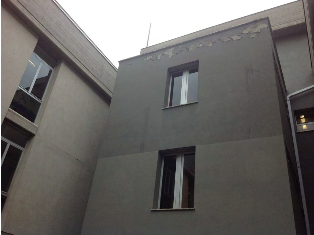
Fig. 55 – Facciata con scrostature
