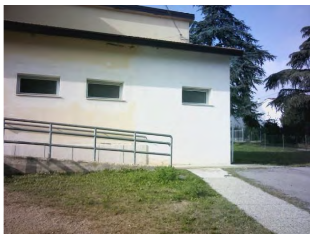
Fig. 25 – Presenza di umidità in facciata
