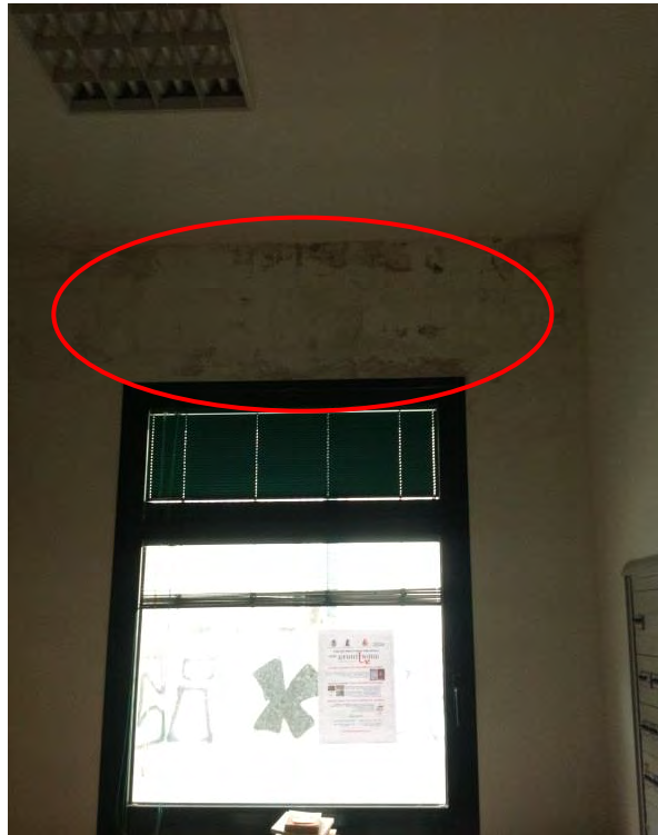
Fig. 8 – Infiltrazioni d’acqua e conseguente sfogliatura dell’intonaco per umidità
