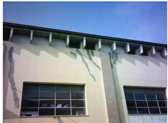
Fig. 32 – Lesioni in facciata
