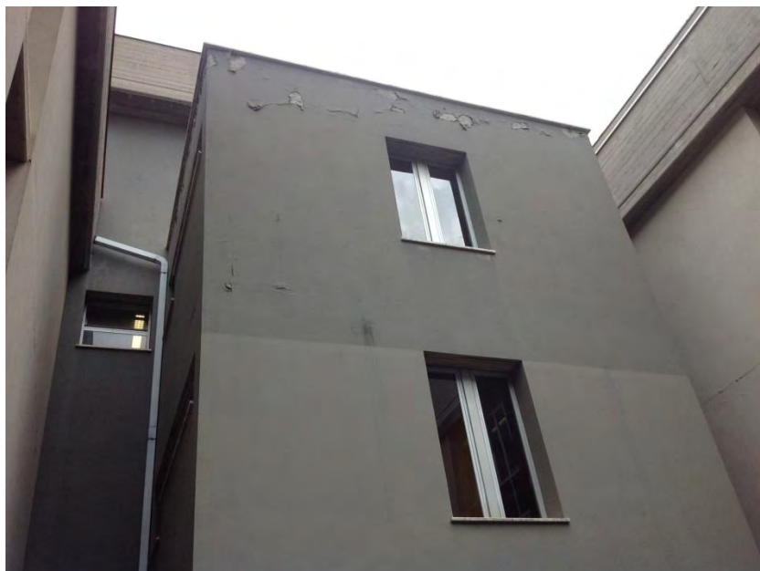
Fig. 52 – Particolare scrostature in prossimità della copertura
