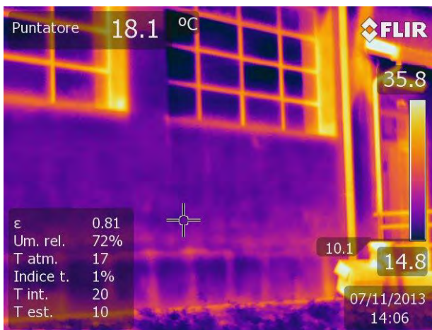
Fig.27 – Presenza di umidità in facciata
