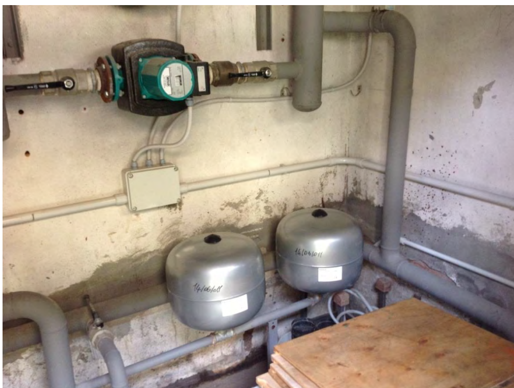
Fig. 5 - Particolare della rete di distribuzione della sottocentrale
