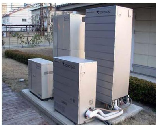
Figura 1 - Cogenerazione Residenziale: impianto dimostrativo con Fuel Cells di Tokyo Gas [1]
