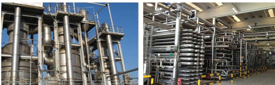
Figura 15 – Impianti di evaporazione-concentrazione e di sterilizzazione o pastorizzazione
