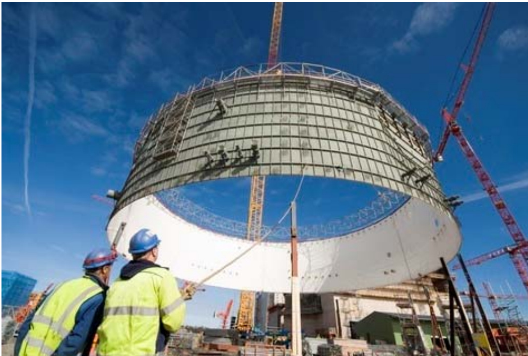
Figura 4 Steel liner (Galleria immagini da www.tvo.fi )
