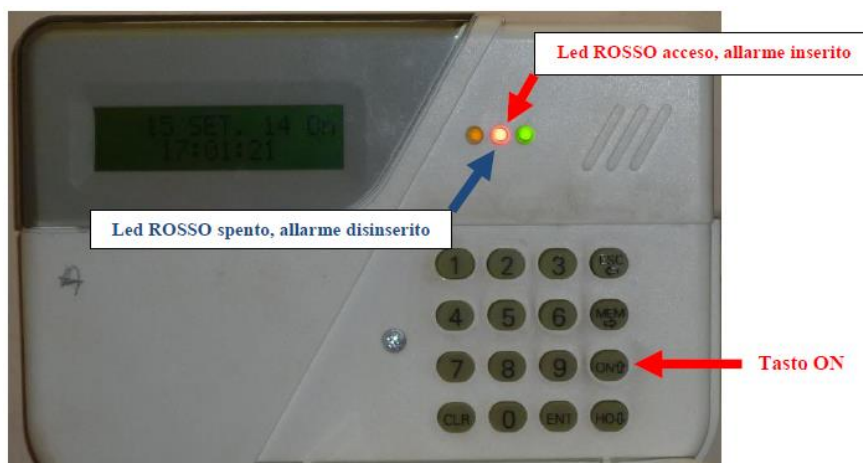
Figura 37 - Centraline allarme casematte 1 e 2
