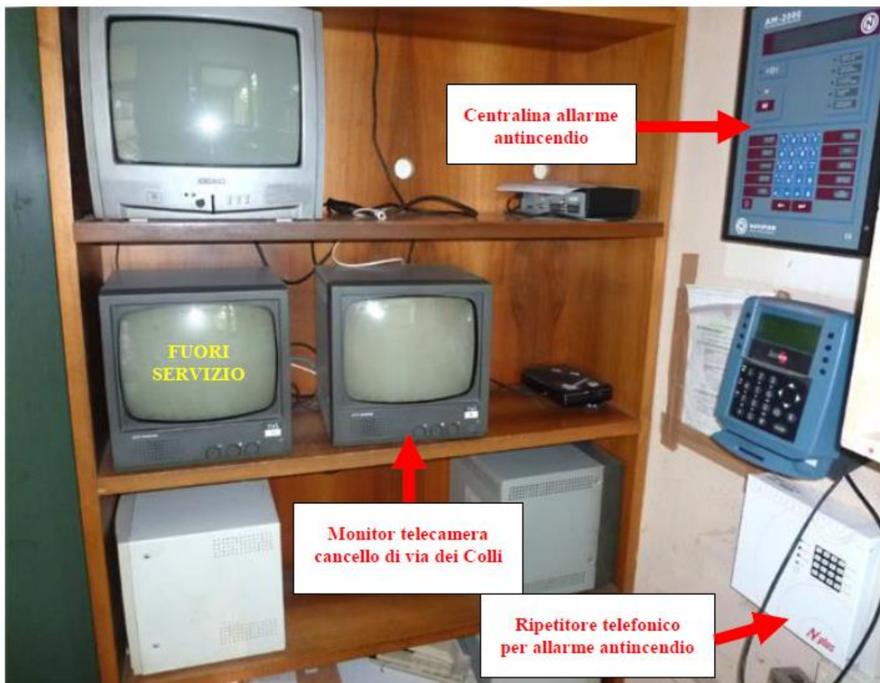
Figura 43 - Portineria hall, monitor e centralina antincendio
