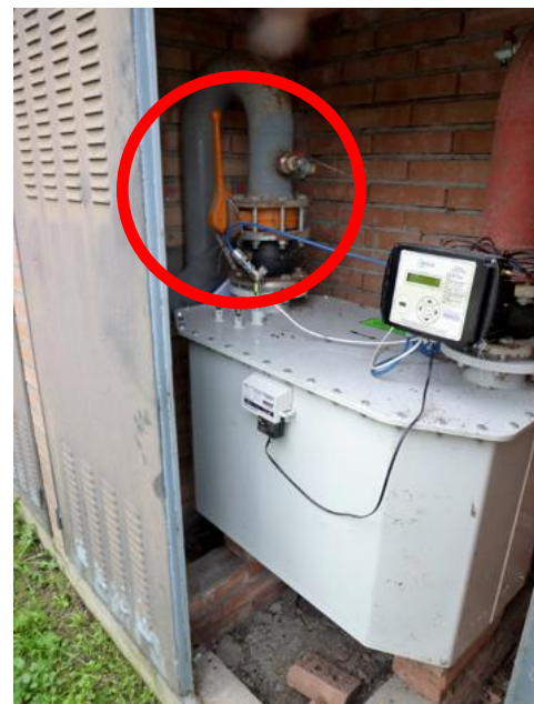
Figura 26 bis – Valvola generale del gas
