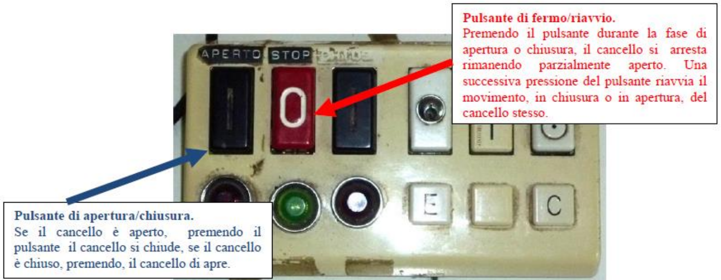
Figura 42 - Pulsante di comando del cancello principale di via dei Colli
