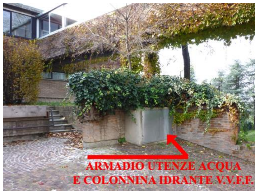
Figura 30 – Armadio utenze acqua e colonnina idrante Vigili del Fuoco
