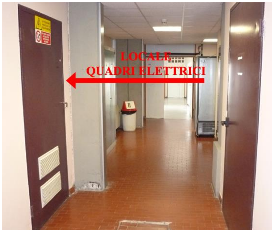
Figura 28 – Locale quadri elettrici
