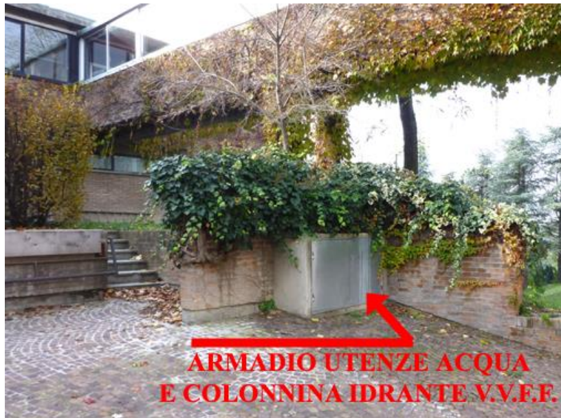
Figura n. 17 – Armadio attacco autopompa VV.F.
