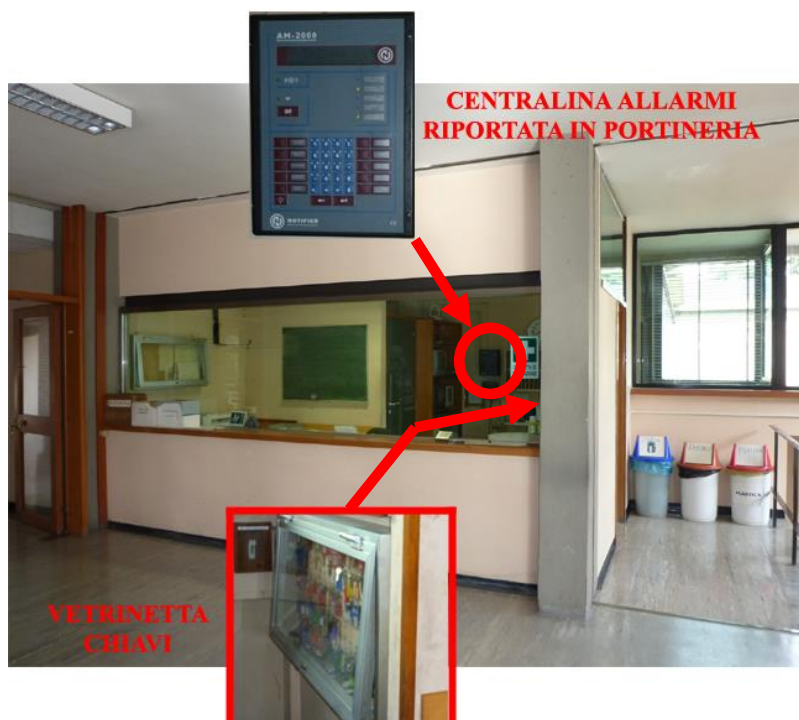
Figura 34 – Portineria interna con la centralina allarmi e la bacheca delle chiavi
