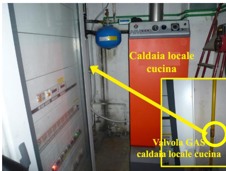
Figure 2.15 – Ubicazione valvola del GAS caldaia locale cucine
