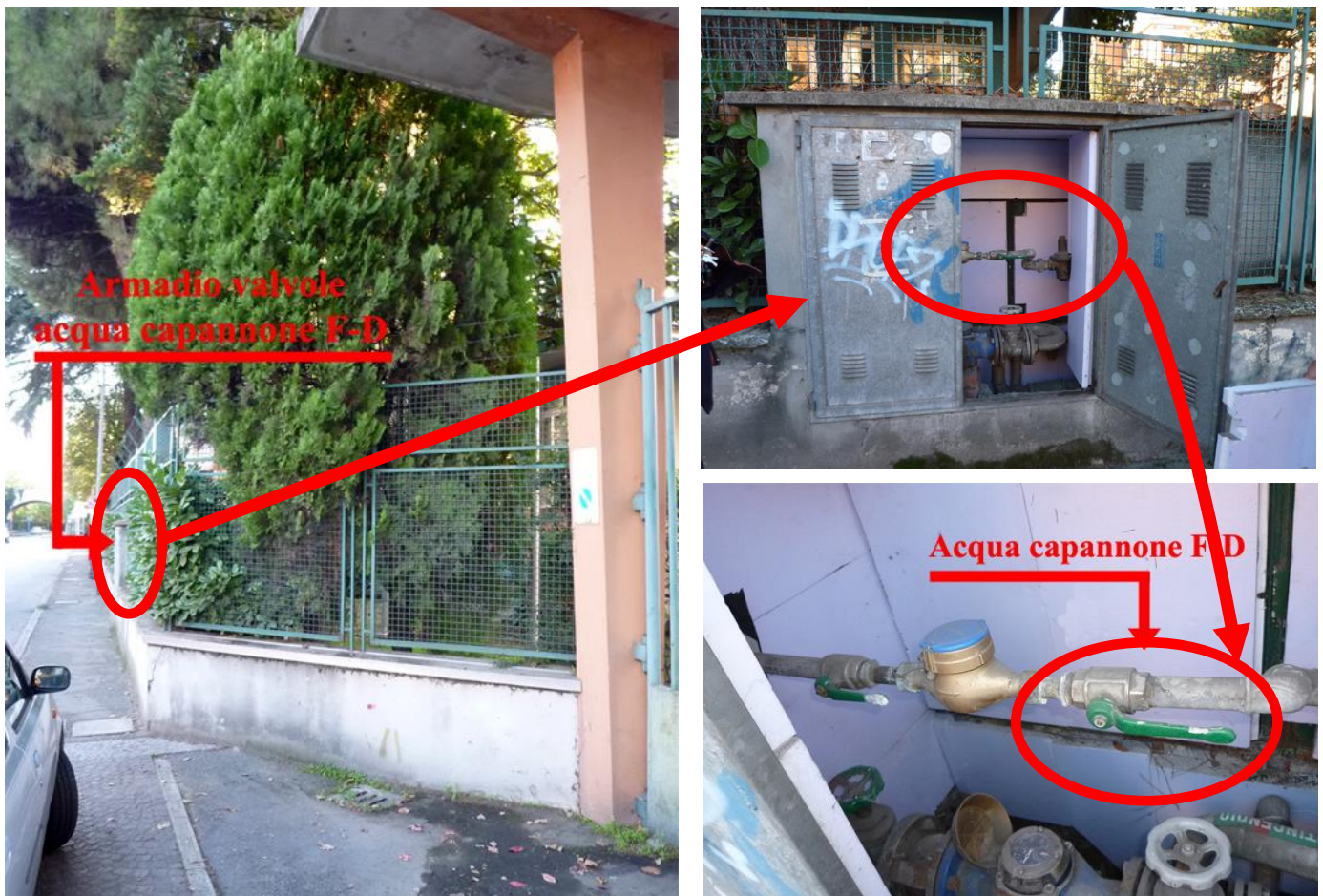
Figura 5.20 –Il vano valvole acqua capannone F-D.
