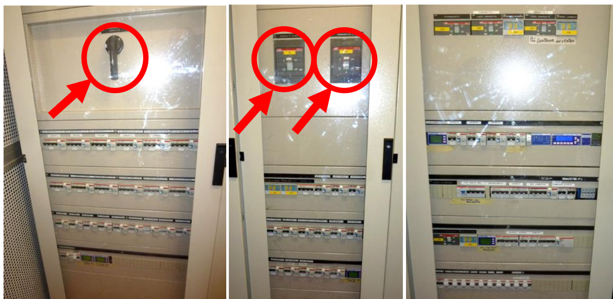
Figura 10.7 – Locale quadri elettrici
