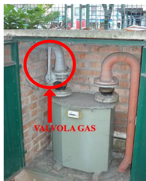
Figura 2.7 - Valvola di intercettazione del gas capannone F-D
