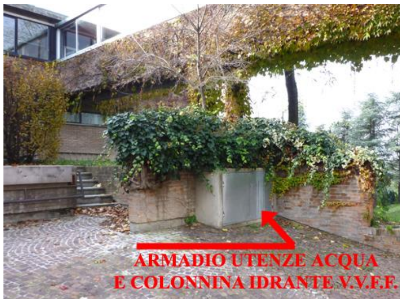
Figura 10.8 – Armadio utenze acqua e attacco idrante Vigili del Fuoco
