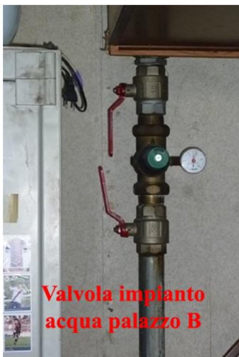
Figura 5.11 –Valvola impianto acqua potabile palazzo B
