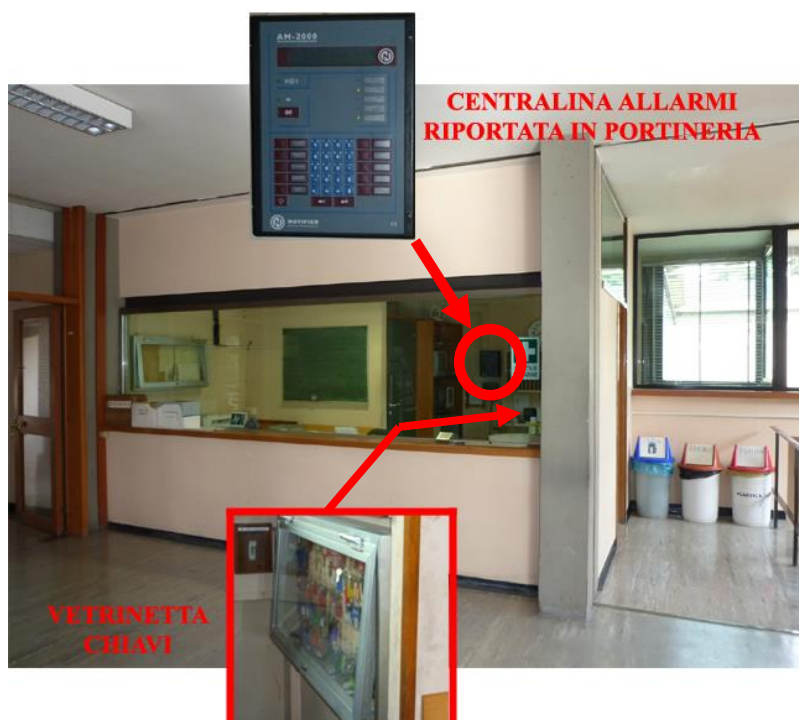
Figura 10.12 – Portineria interna con la centralina allarmi e la bacheca delle chiavi
