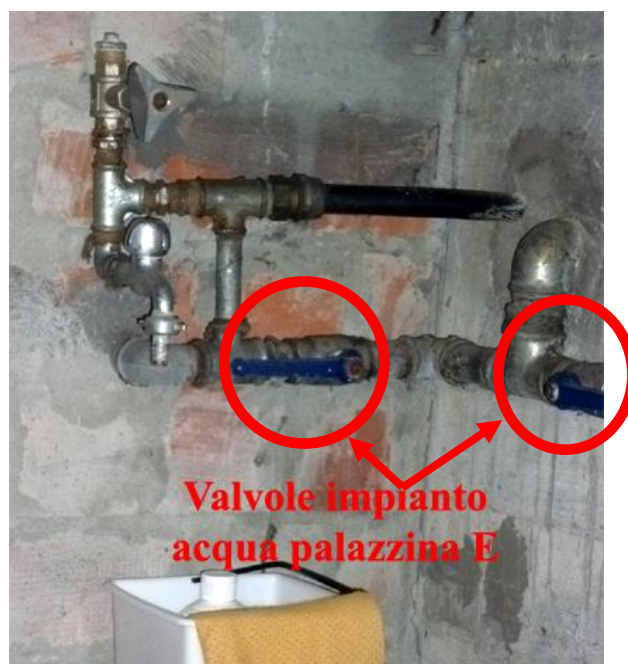
Figura 5.18 – Valvole impianto acqua palazzina E
