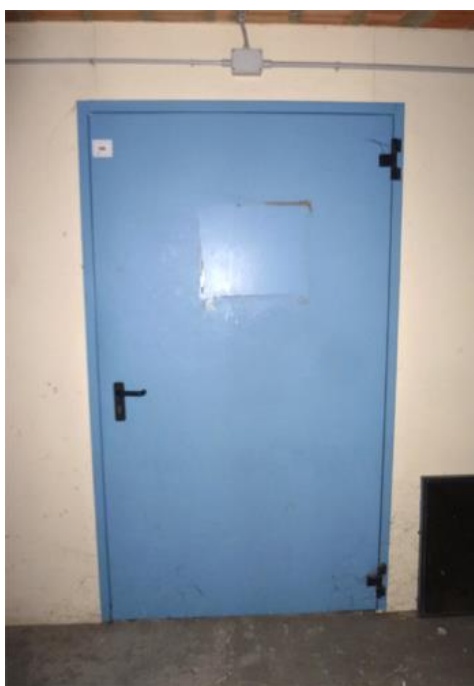
Figura 3.16 – Porta del locale ove è ubicata la cabina elettrica
