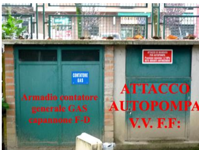
Figura 7.2 – Armadio attacco autopompa V.V.F.F. e, a sinistra, l'armadio contenente il contatore generale gas capannone F-D
