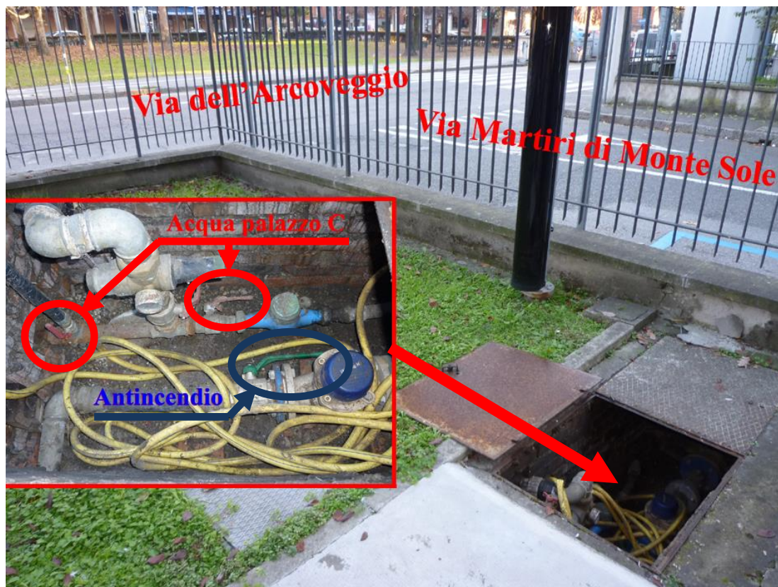
Figura 9.10 - Valvole generali acqua palazzo C
