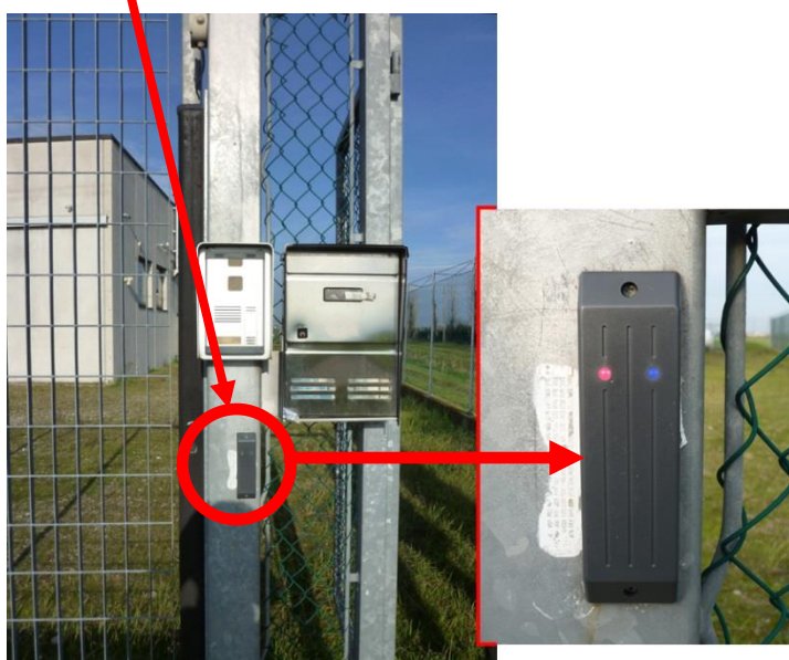
Figura 11.9 –Lettore per inserimento – disinserimento impianto di allarme perimetrale
