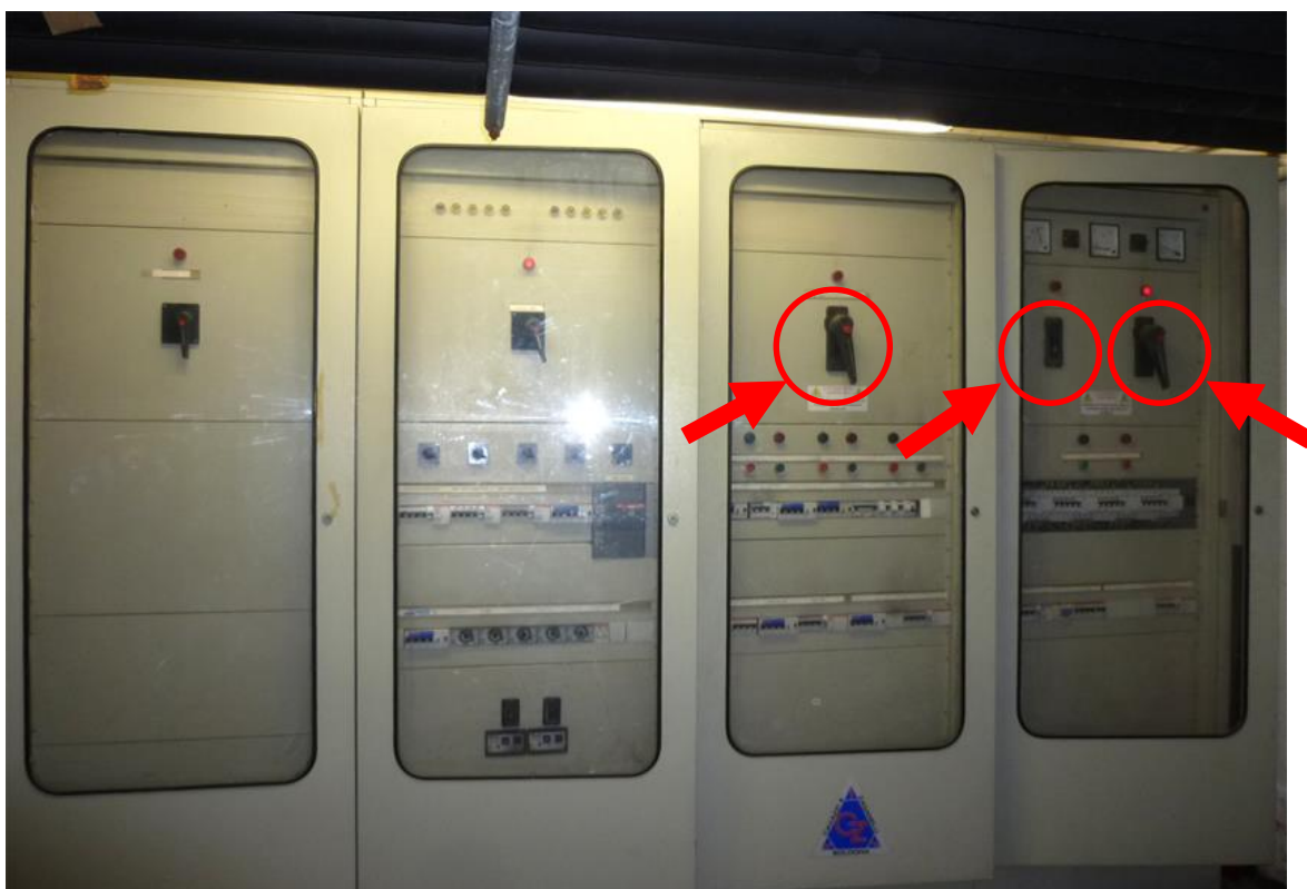
Figura 3.10 – Quadri elettrici generali capannone F-D
