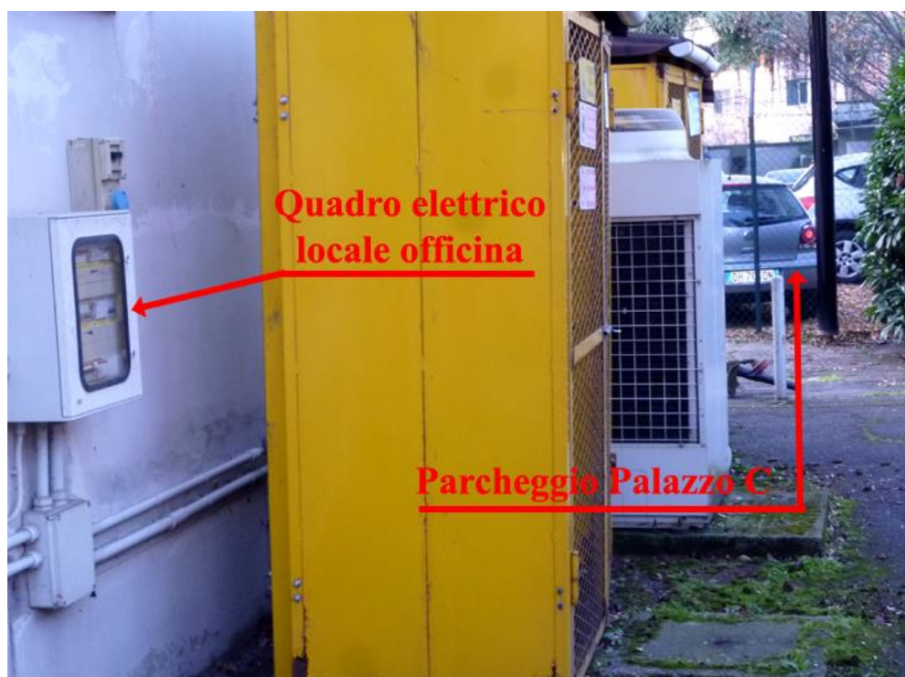
Figura 9.9 - Quadro elettrico locale officina
