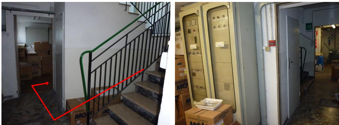
Figura 9.5 e 9.6– Locale quadri elettrici palazzo C
