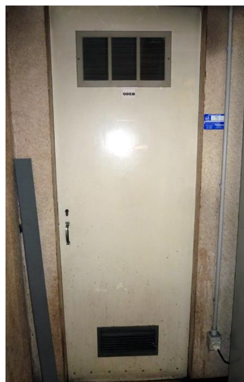
Figura 4.2 – Locale allarmi (stanza 005B)
