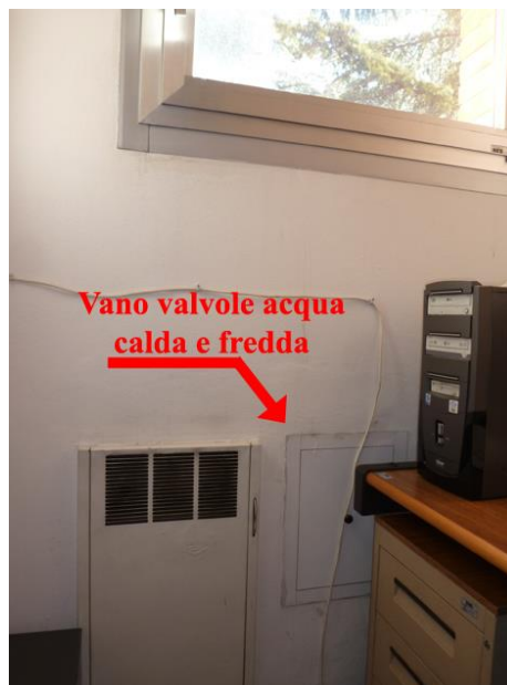
Figura 5.16 – Valvole acqua calda e fredda cucinotto stanza x08B
