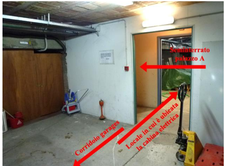
Figura 3.16 Cabina elettrica, accesso dal corridoio garages
