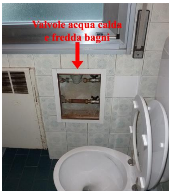
Figura 5.15 – Valvole acqua calda e fredda bagni
