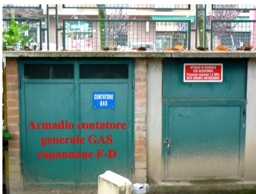
Figura 2.6 – Armadio contatore generale gas capannone F-D e, a destra, il vano idrante VV.FF.
