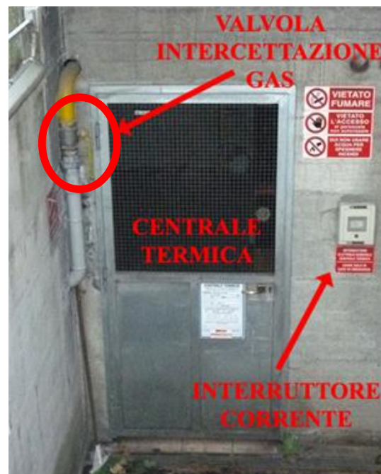
Figura 2.13 – Ingresso centrale termica palazzina E
