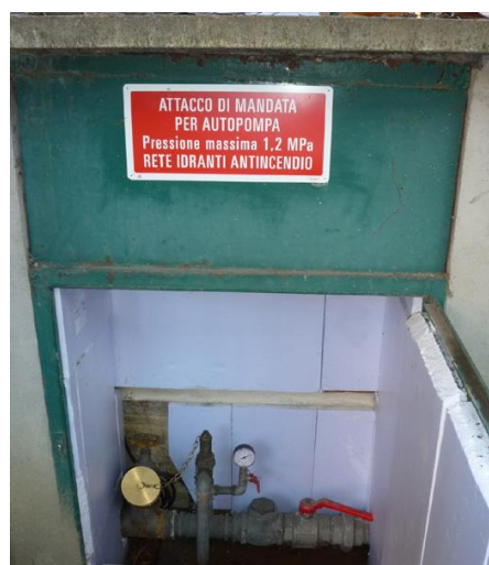
Figura 7.3 – Attacco autopompa V.V.F.F.
