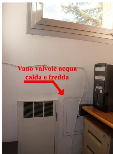
Figura 5.8 – Valvole acqua calda e fredda cucinotto stanza x03A
