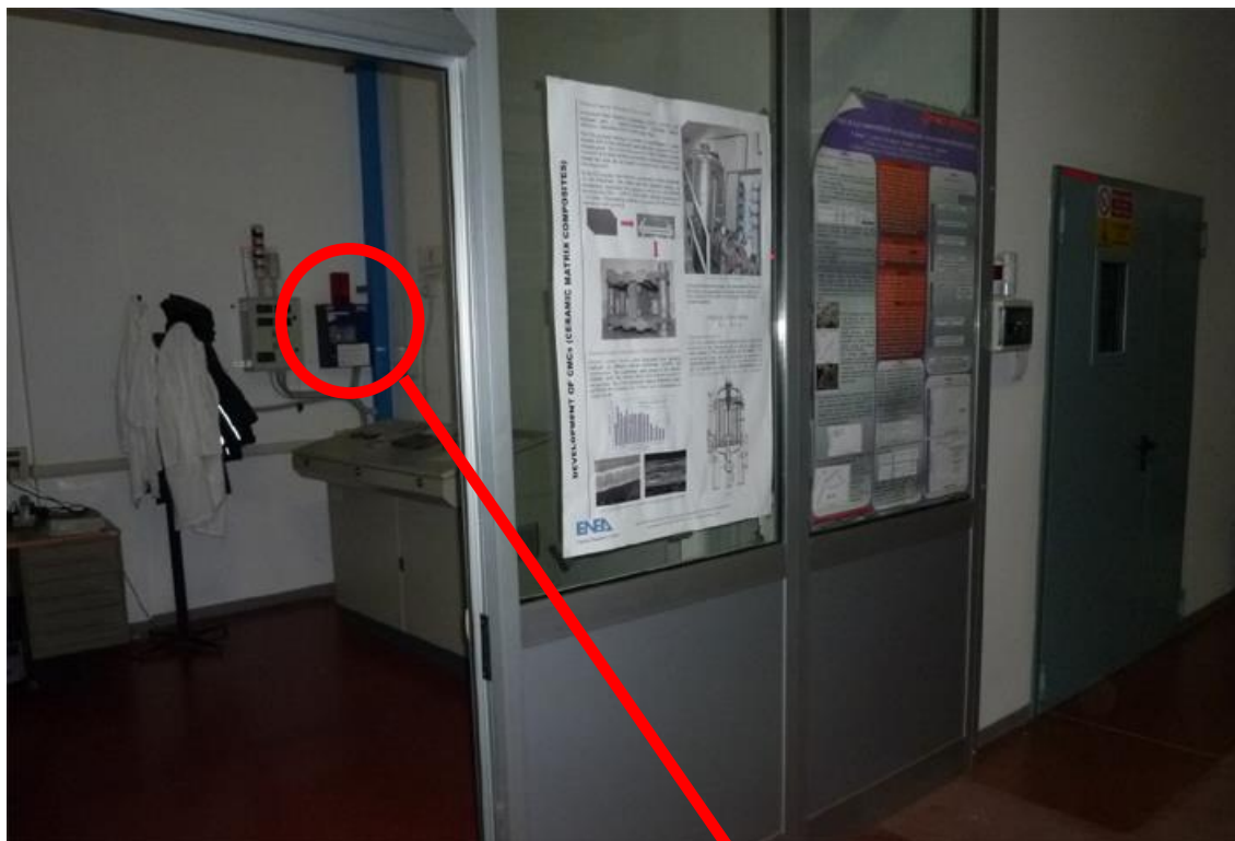
Figura 36 – Sala controllo CVI e relativa centralina
