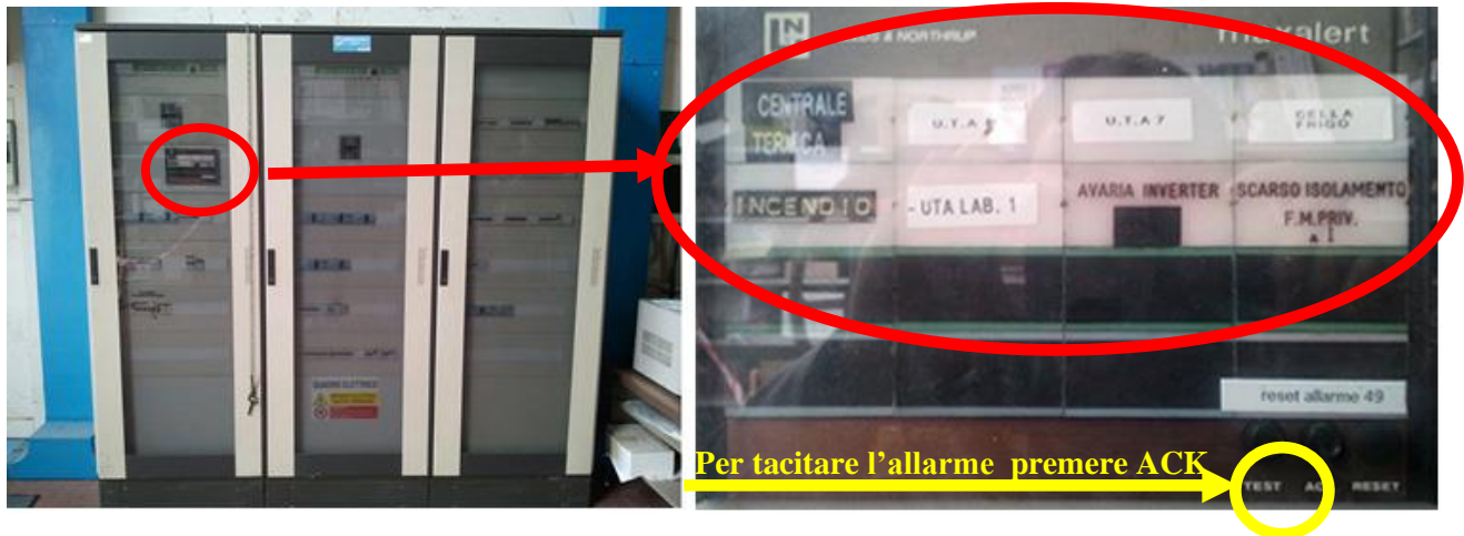
Figura n. 33 – Display allarmi zona ampliamento
