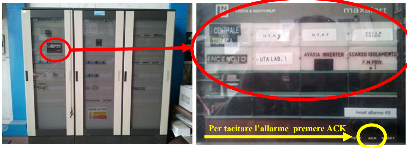
Figura n. 27 – Display allarmi zona ampliamento
