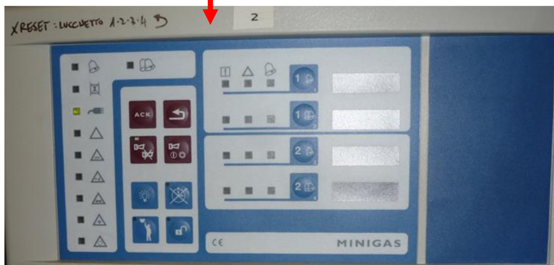
Figura 34 – Centrale termica 1 e relativa centralina allarmi
