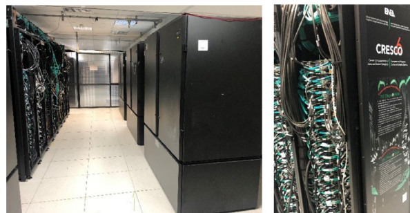
Fig. 3.2. HPC CRESCO6 in ENEA-R.C. Portici (courtesy of Davide De Chiara).
