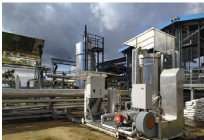
Vista del circuito sperimentale ORC-PLUS
