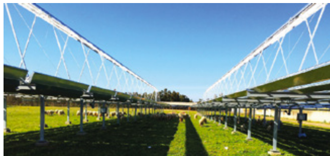
Nuova Sarda Industria Casearia. Impianto solare a concentrazione progettato da CSP-F SpA per la produzione di calore di processo industriale
