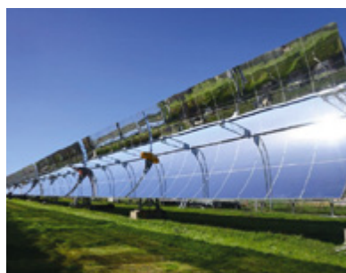
Vista del collettore solare
