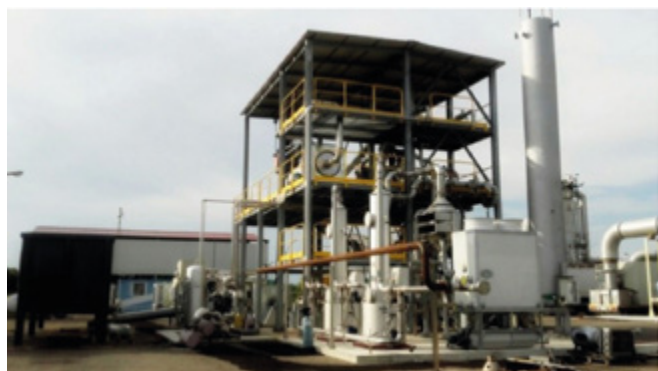
Impianto pilota di gassificazione multistadio da 500 kW
