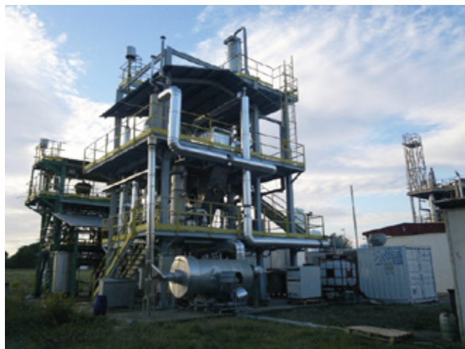
Impianto di gassificazione dell'infrastruttura PIBE
