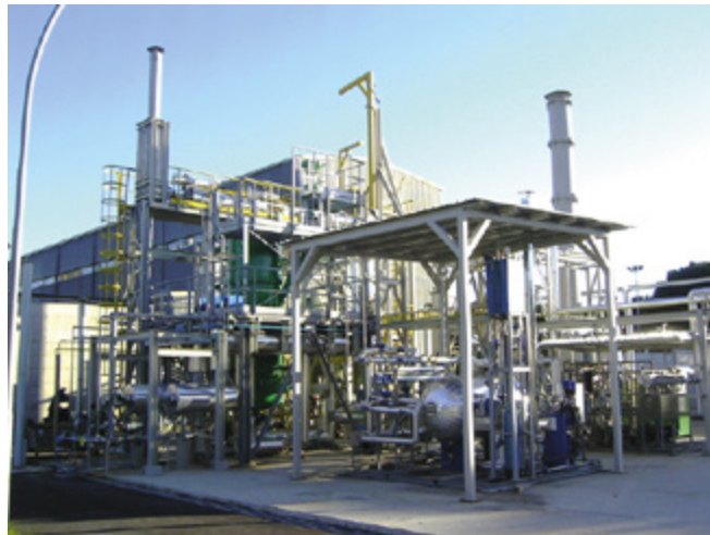
Impianto pilota ZECOMIX
