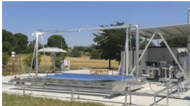
Esempio di collettore Linear-Fresnel in fase di test presso il Laboratorio
