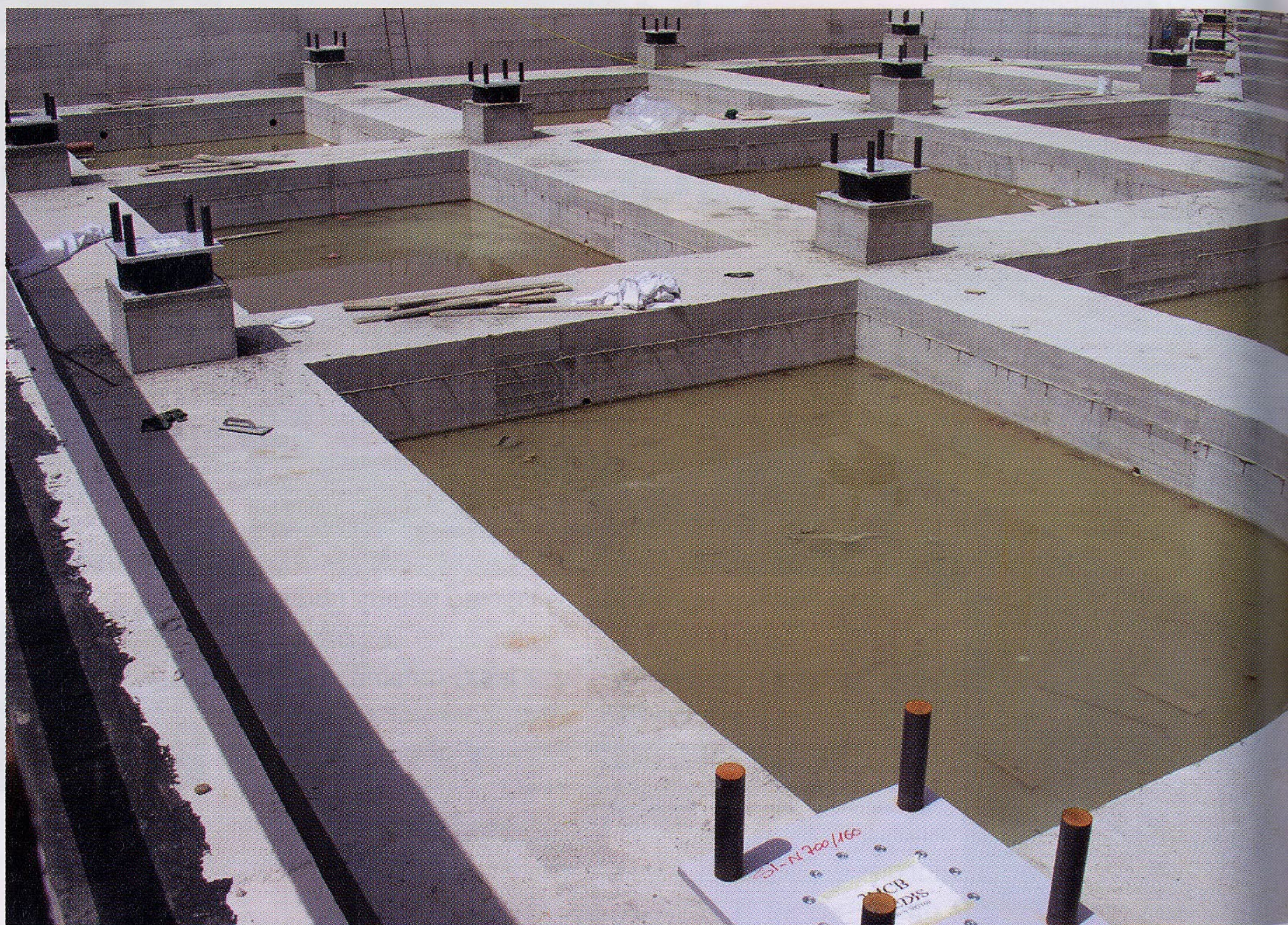
Nella foto, isolatori HDRB installati nelle fondazioni della nuova scuola di San Giuliano di Puglia.
