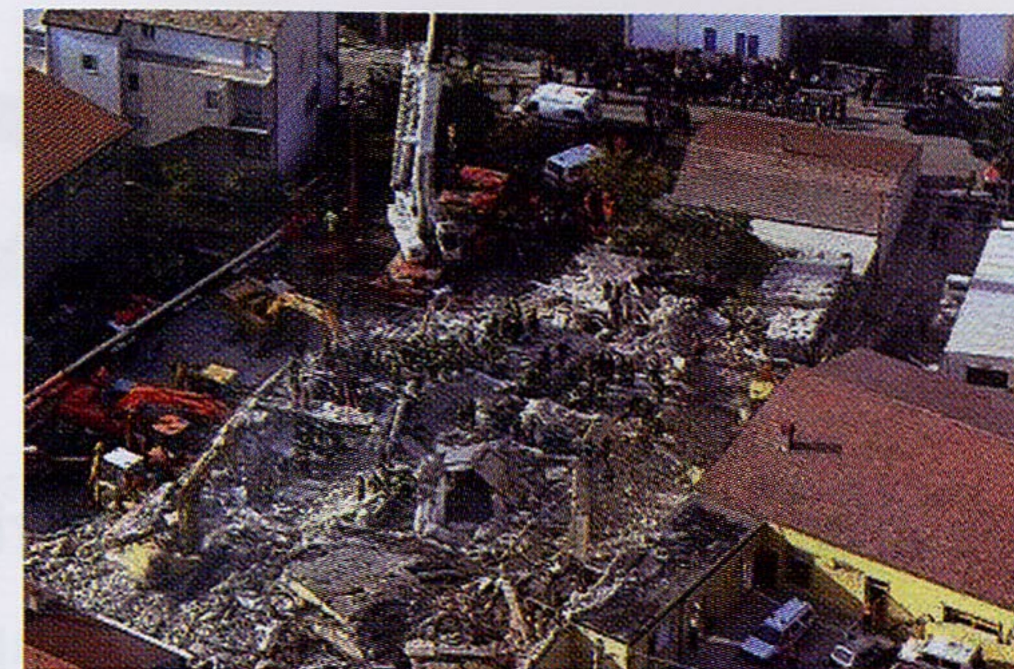
Sopra, effetti del terremoto del 31 ottobre 2002.
