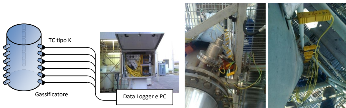
Figura 256. Monitoraggio termico del gassificatore della Piattaforma Pilota: disposizione dei sensori TC e quadro di acquisizione, particolari delle installazioni
