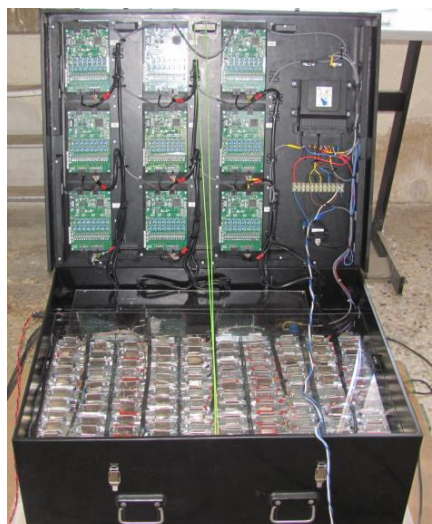
Figura 63. Vista della parte interna del pacco batterie
