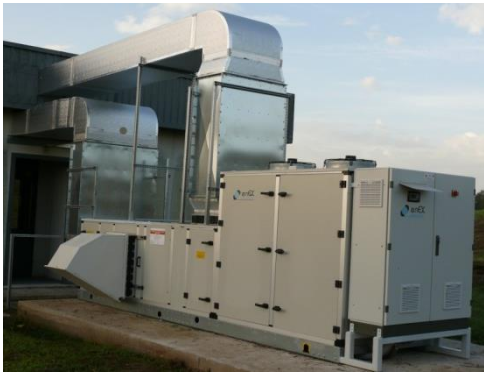
Figura 479. Roof-top posizionato al suolo per motivi di sperimentazione
