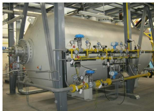
Vessel, vista lato combustore e rampa gas
