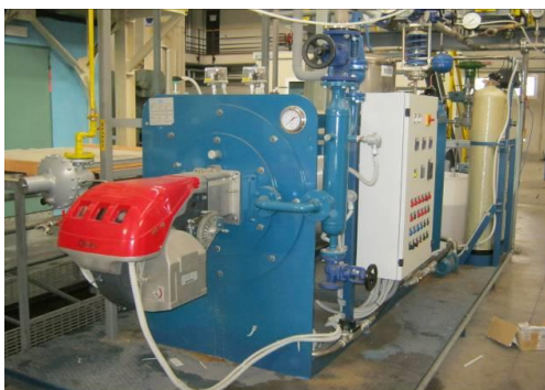
Generatore di vapore
