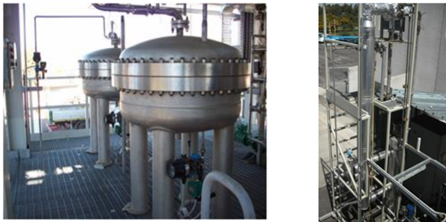
Figura 250. Reattori a bolle e unità di rigenerazione dell'impianto pilota
