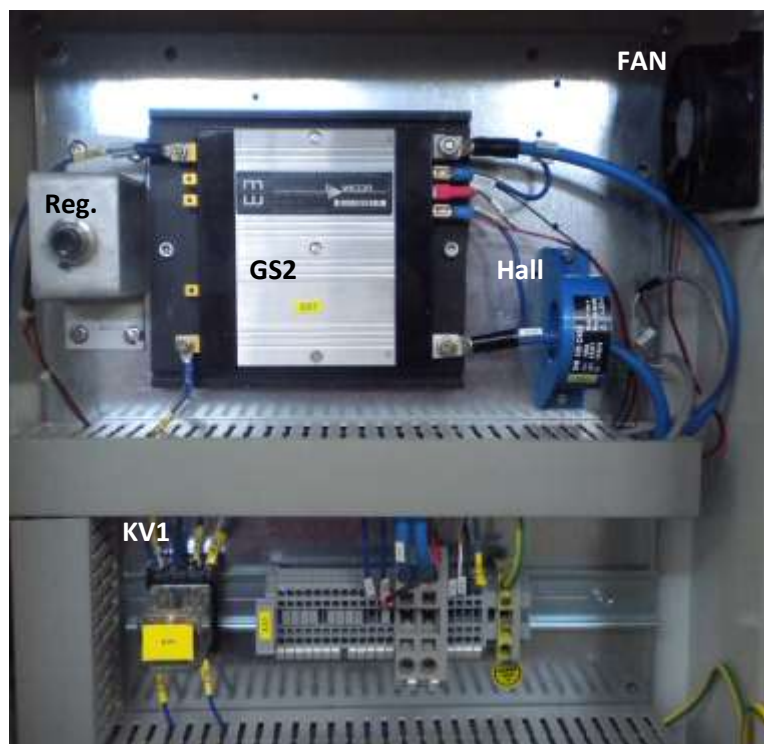
Fig. 10 – Quadro elettrico alimentatore pompa elettromagnetica.
