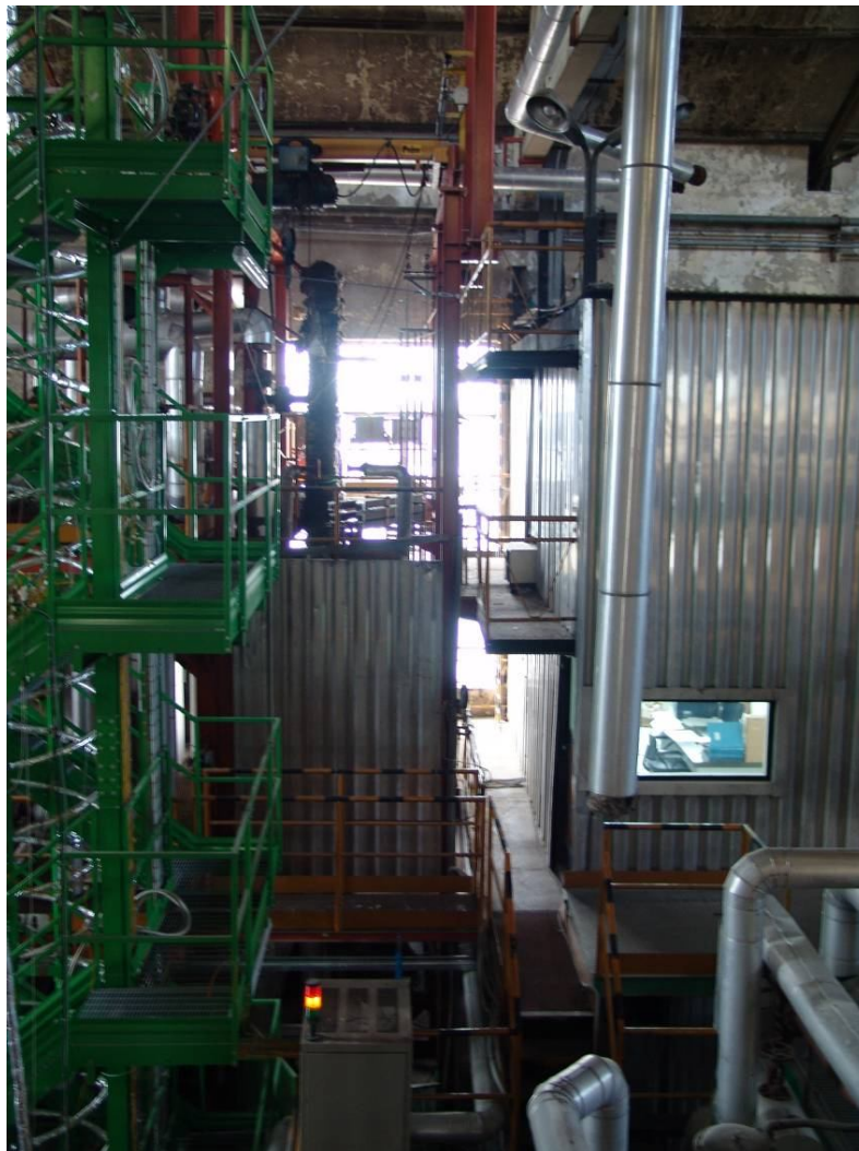
Fig. 3 - Vista d'insieme dell'impianto IETI
