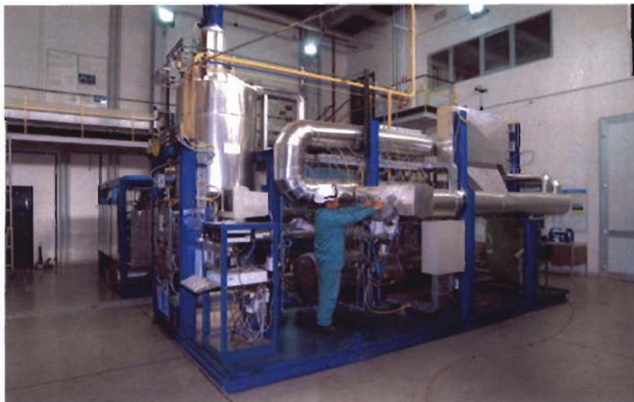
Fig. 4.19 – Impianto LECOR nell'edificio sperimentale CPC1
