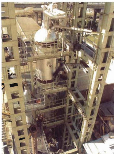
Fig. 4.5 – Impianto GEST con vessel da 45 m 3 (fonte: Siet)
