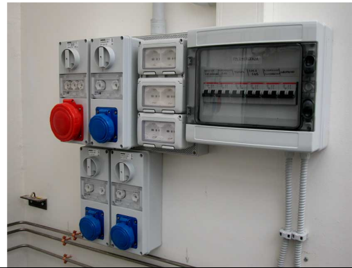
Prese elettriche a parete
